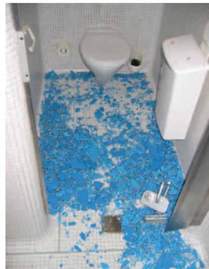
Abb. 6: ESG-Bruchbild – es zerfällt bei Glasbruch meistens vollflächig in viele kleine, stumpfe Teile. Hier ist eine WC-Glastür zerbrochen.
