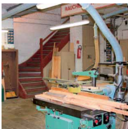
An den Holzbearbeitungsmaschinen dieser Werkstatt befindet sich eine stationäre Absaugung
