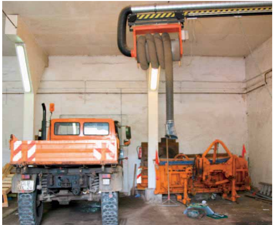
In dieser Halle befinden sich Absaugschläuche für Dieselmotoremissionen
