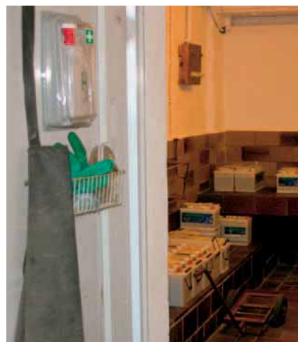
Notwendige Schutzausrüstung in einem Batterieladerraum
