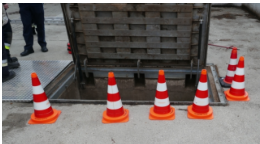
Abb. 2: Nach dem Unfall wurde der Einstiegsschacht (hier durch die Feuerwehr) provisorisch gesichert. Bei Fehlritten hätte auch hier, ohne entsprechende Sicherungsmaßnahmen, ein Absturz in den Schacht erfolgen können.
